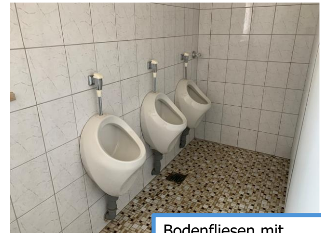
Bodenfliesen mit asbesthaltigem Kleber
